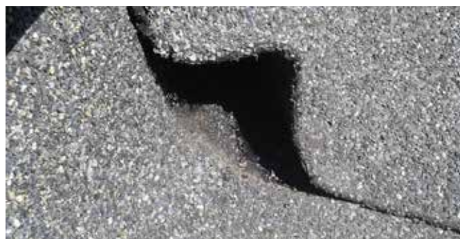
Nieszczelność na zakładach
