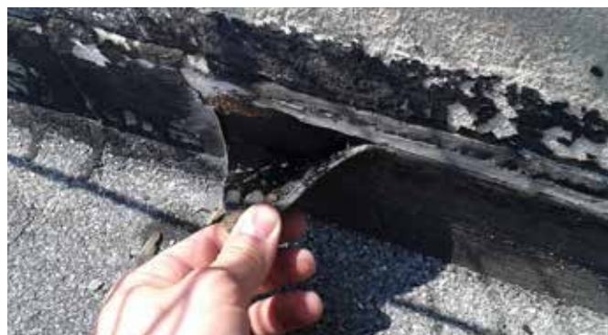
Zniszczona obróbka komina
