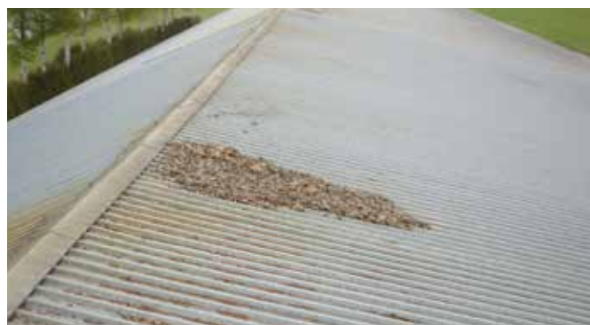
Przykładowe zabrudzenia dachu.
